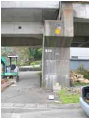
No.13 上越新幹線 (脱線開始付近, 東京側, 長岡市 渡沢町)
